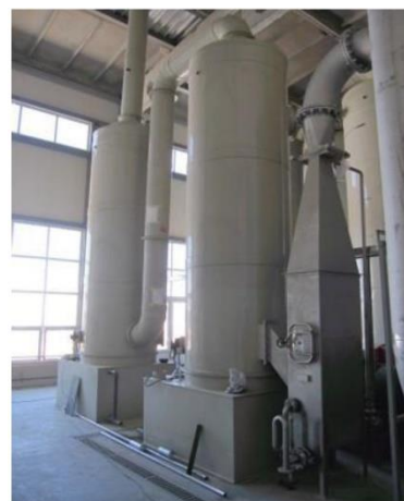
Primjer venturi Scrubber-a
