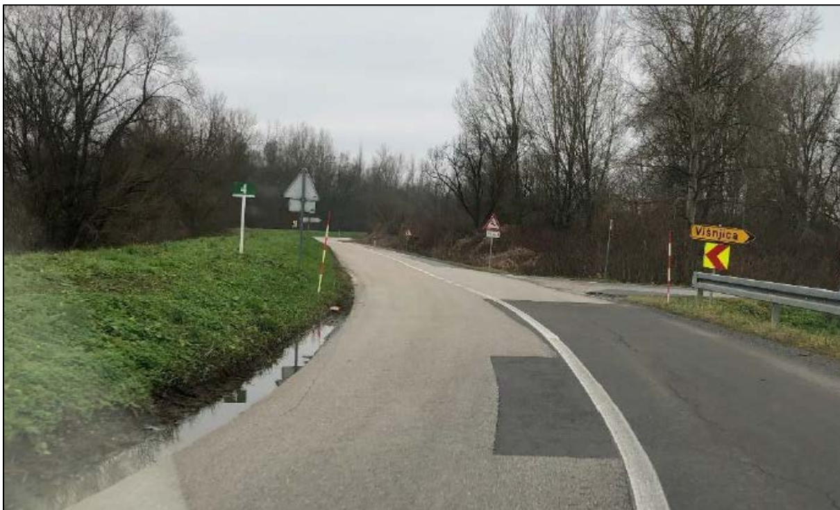
Slika 6. Neriješena odvodnja uz lijevi rub ceste
