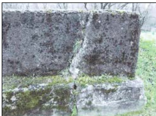
Slika 4. Prikaz oštećenog postojećeg zida na km 3+689
