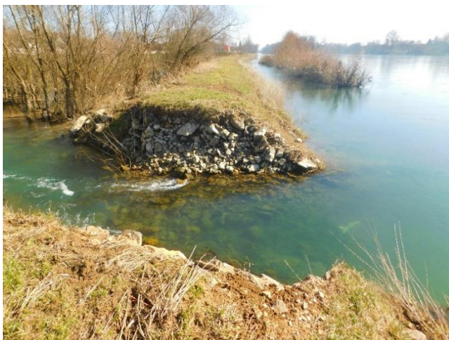
Slika 3-9. Prekinuti dio postojeće kamene uzdužne vodne građevine u blizini Točke 2
