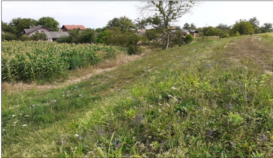
Slika 2.2-1. Postojeće stanje nasipa nakon privremene sanacije berme na zaobalnoj strani (INSTITUT IGH, d.d., srpanj, 2021.)
